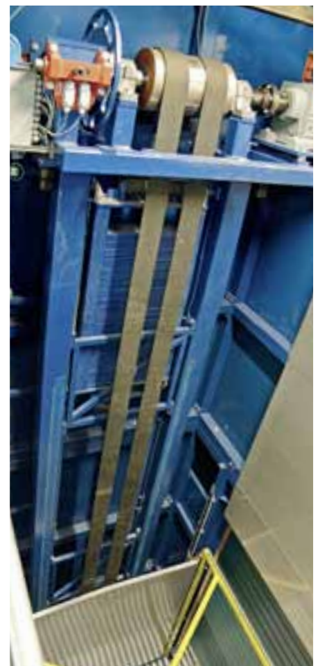
Antriebsstation des Schwerlast-Konsolhebers mit Getriebemotor, Kupplung, Antriebstrommel und Verriegelung
