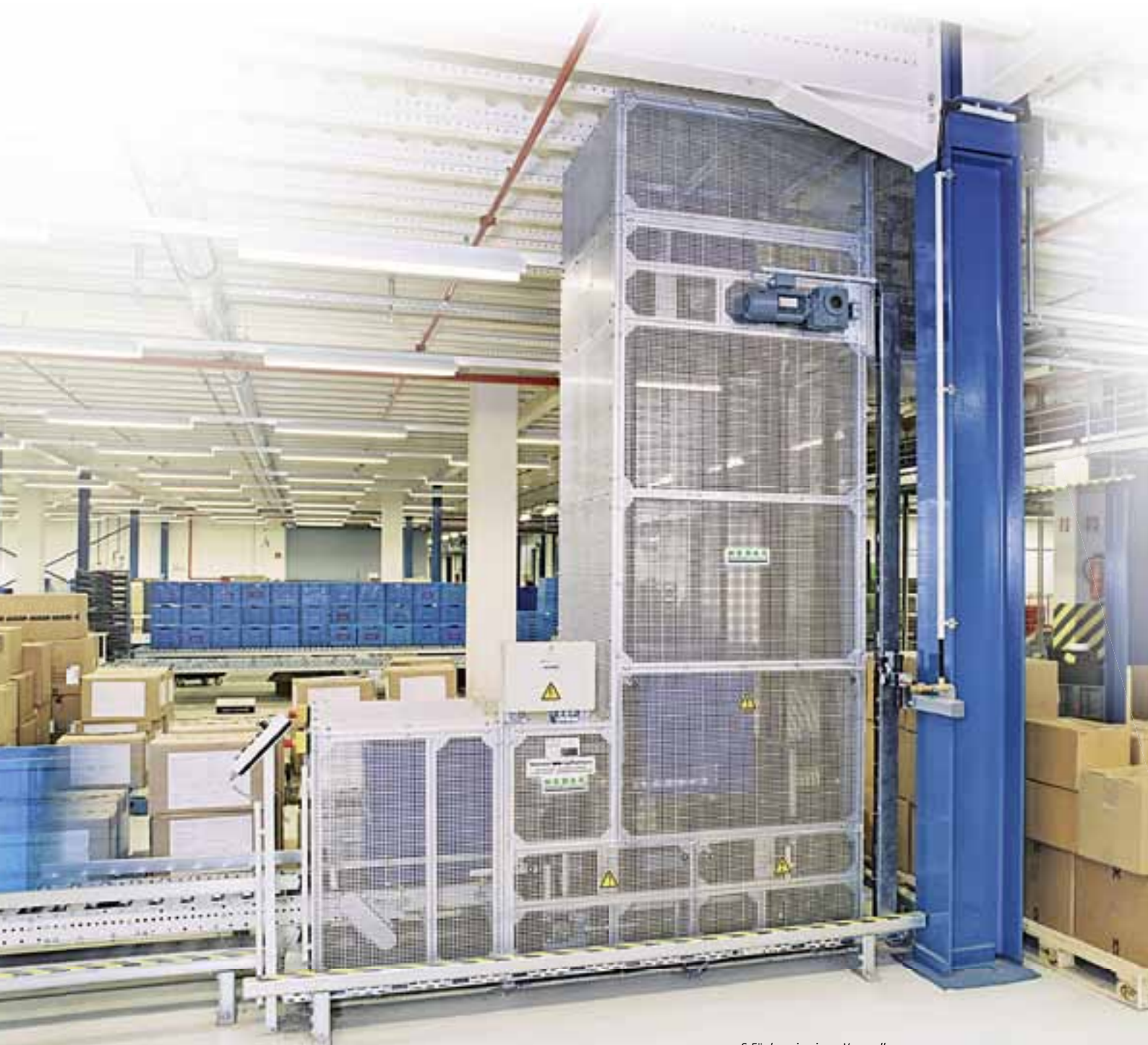
S-Förderer in einem Versandlager
